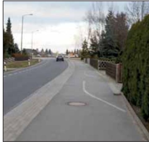
Abb. 14 Markierung Burker Straße
